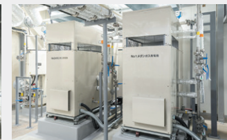
バイオガス発電のマイクロコジェネレーション
