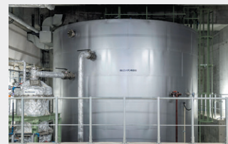
メタン発酵槽(省スペース型)
