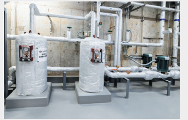
膨張タンクと熱源水ポンプ
