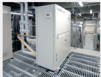
下水熱ヒートポンプ
